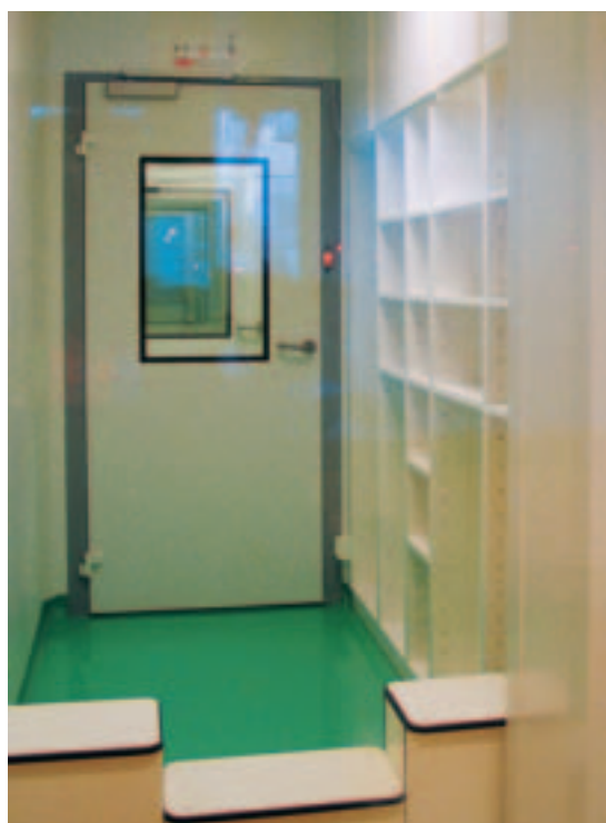
Vue d'un SAS d'entrée d'une zone protégée
